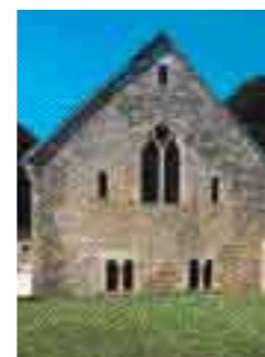
FONTENAY (Côte-d'Or, Bourgogne). Le mur pignon sud de la chapelle des étrangers (xii e s.) restaurée au xx e siècle.
